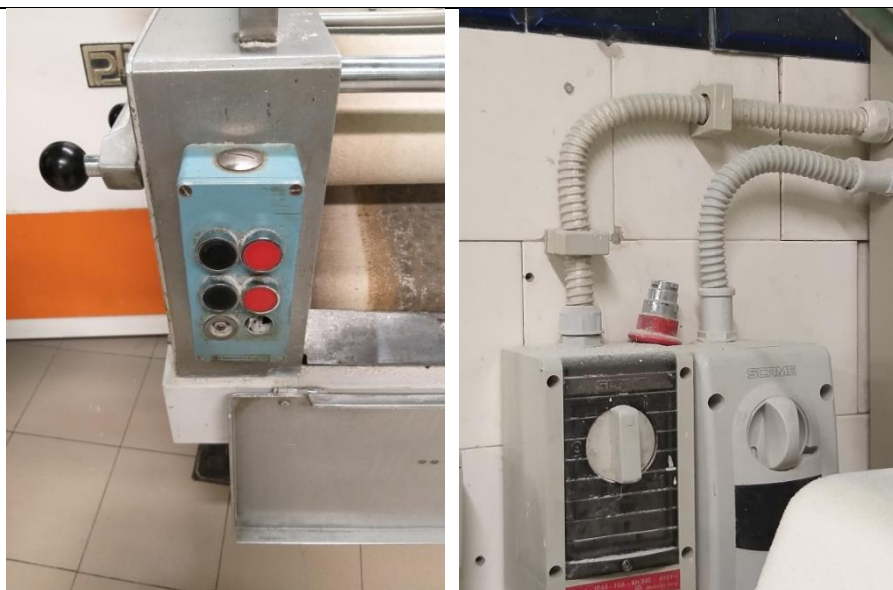
Fig. 2 Quadro comando senza dispositivo di arresto di emergenza che si trovava posizionato sopra interruttori elettrici (foto a destra)
