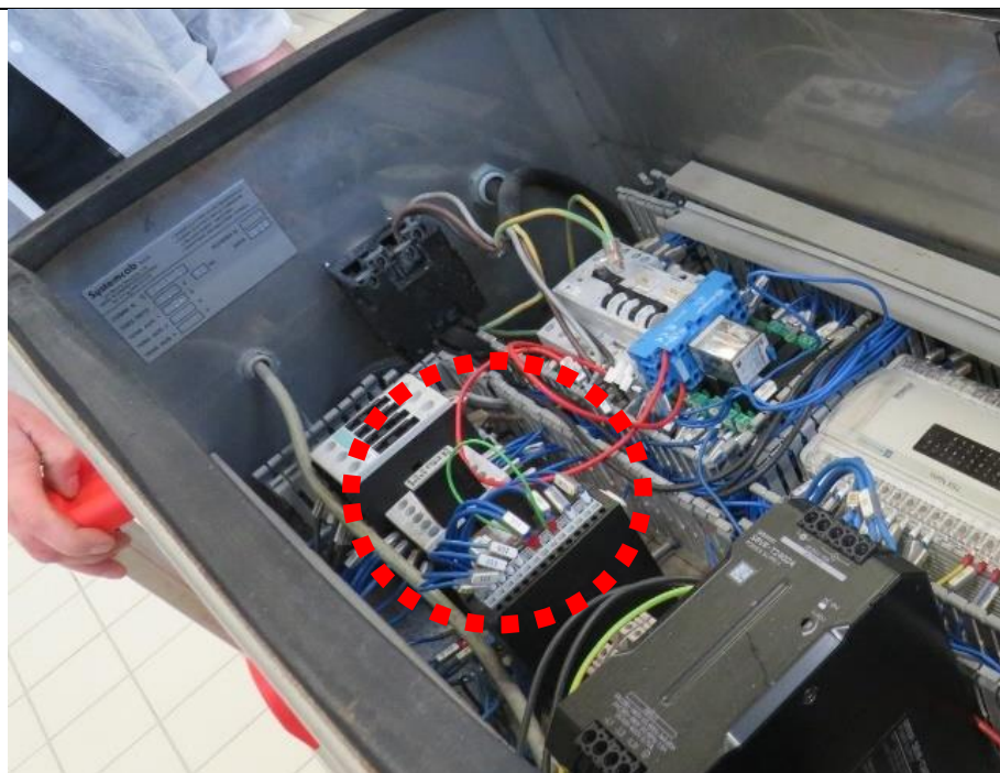
Fig.3 – quadro elettrico con evidenziato il “ponticello” elettrico (conduttore color verde) che consente di eludere la funzione di sicurezza del riparo interbloccato
